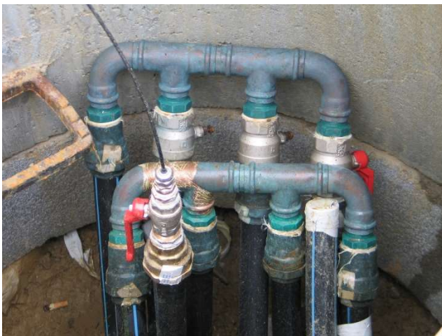
Sondenkopf mit eingebautem faseroptischen Kabel
